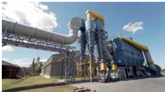
Planta de tratamiento de humos en FV
